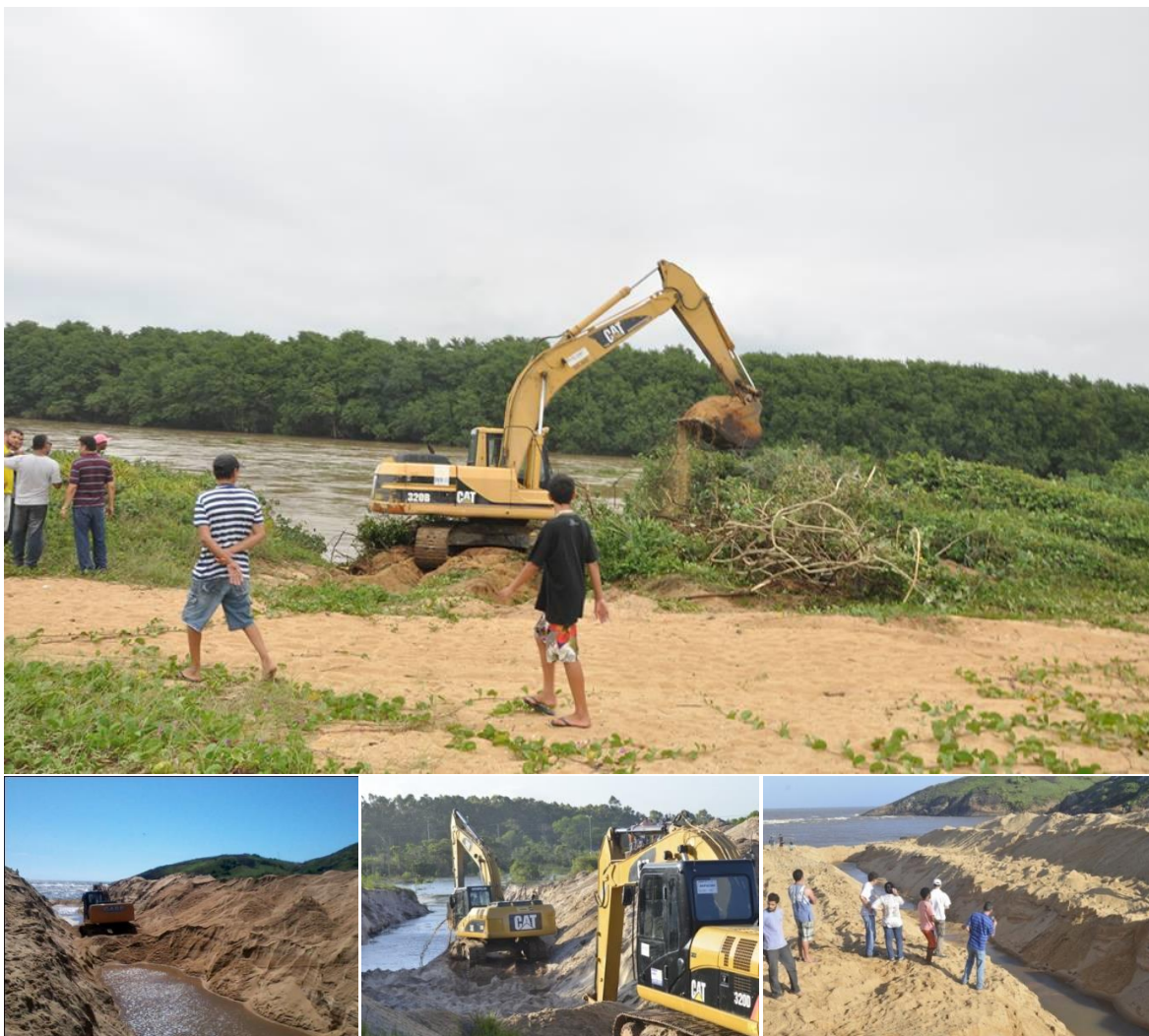
Figuras 69, 70, 71 e 72 - Destruição da praia de Jacarenema em tentativa infrutífera de diminuir os alagamentos em Vila Velha. A última imagem da sequência mostra o canal fechado para impedir a entrada do mar.
