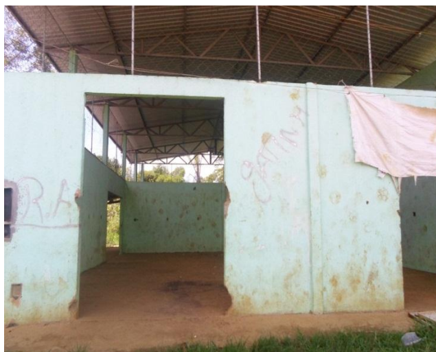
Figura 10 – Galpão construído para a COOLIMPA, completamente depredado.
