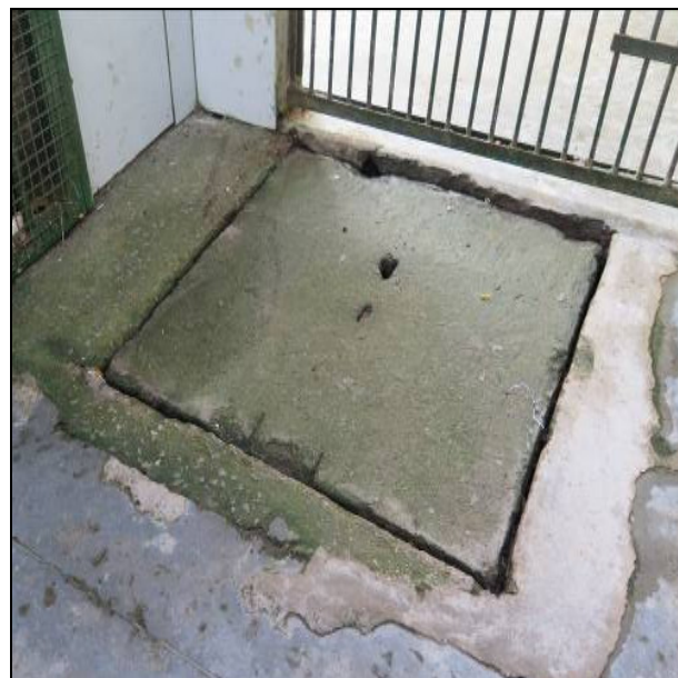
Fig. 26: Acúmulo de umidade e algas em argamassa de reparos preparada sem aditivo impermeabilizante.
