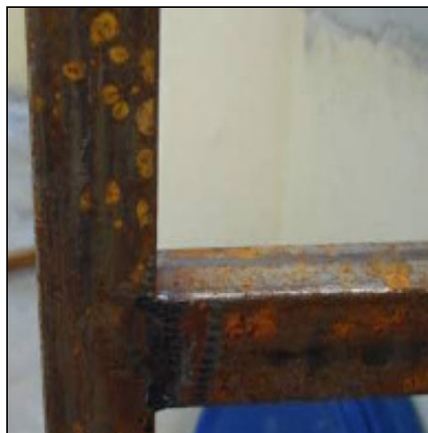
Fig. 29: Esquadrias de aço não-galvanizado, sem pintura protetora, oxidada por produtos com cloro.
