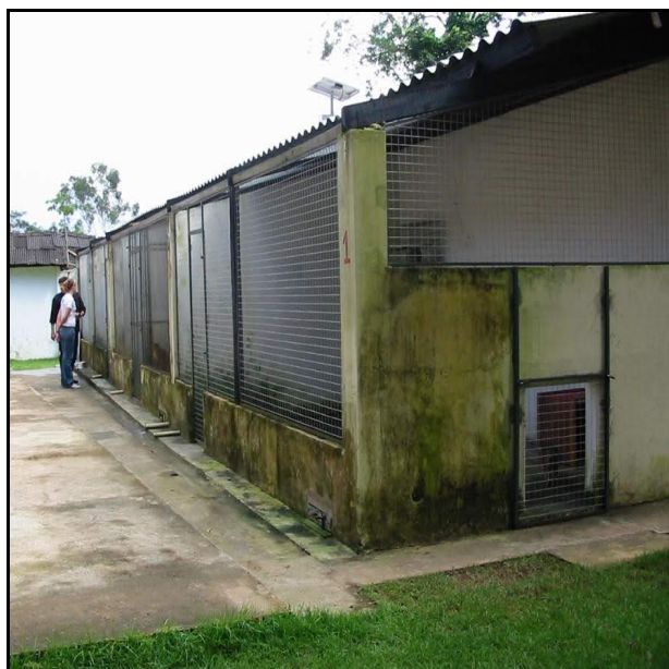
Fig. 11: Um projeto e materiais de construção inadequados tendem a gerar custos consideráveis para a reforma de Centros de Reabilitação.
