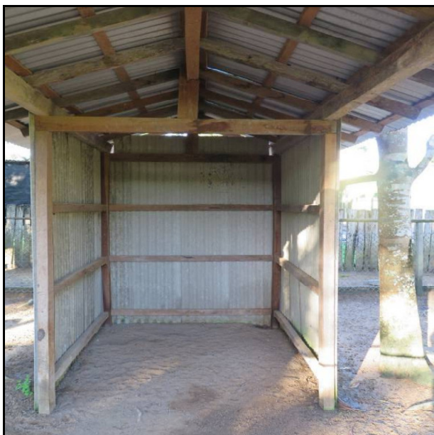
Fig. 83: A madeira acumula resíduos, mas favorece a construção acelerada de estruturas emergenciais.
