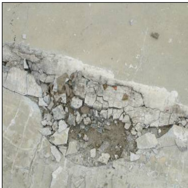
Fig. 25: Argamassa com traço e revestimento inadequado, danificada pela lavagem diária.
