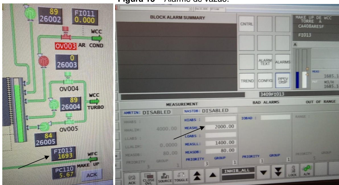
Figura 13 – Alarme de vazão.
