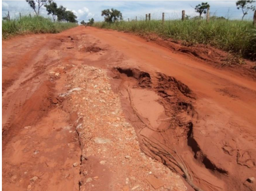
Figura 10 - Processo erosivo em uma estrada não pavimentada em Ituiutaba – MG. Fonte: Pontal em Foco
