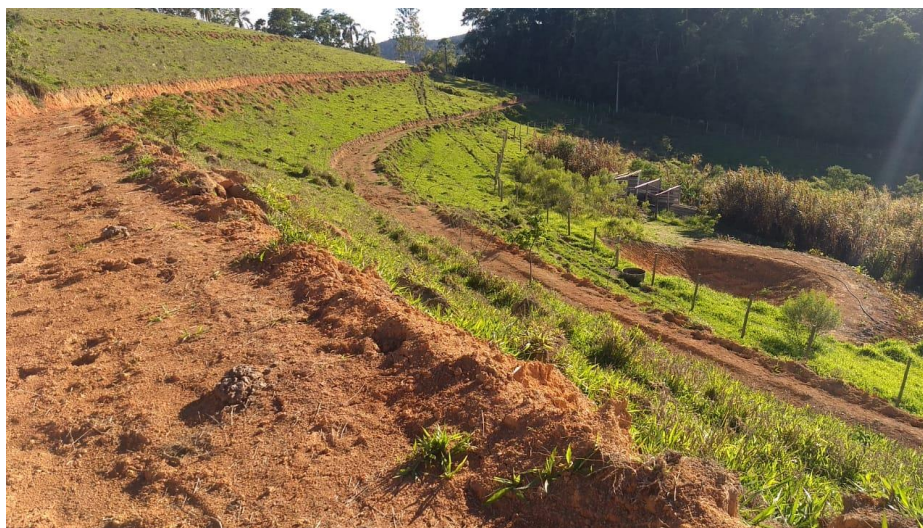
Figura 12 - Terraceamento e barraginha em propriedade rural de Nazaré Paulista-SP - Projeto Semeando Água - IPÊ
